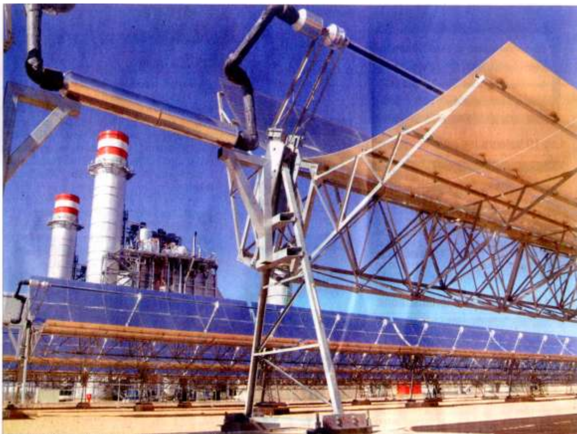
La centrale thermo-solaire de Tabaddart.
